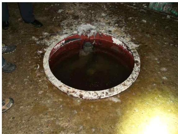
사고 후 탱크 내부
