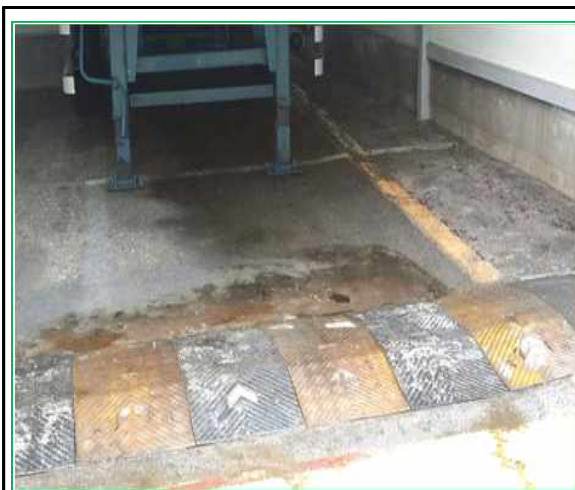
개선 전 하역장 방재시설
