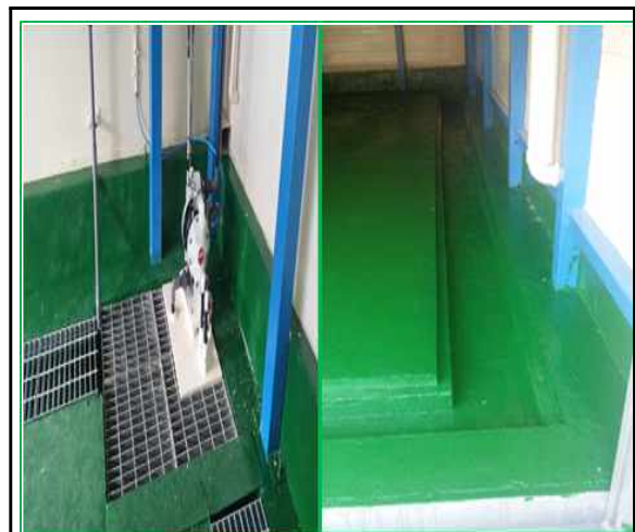
개선 후 폐수이송 시설
