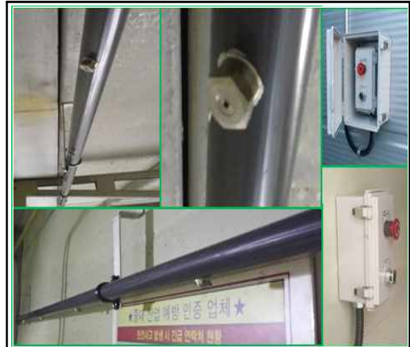
개선 후 방재시설
